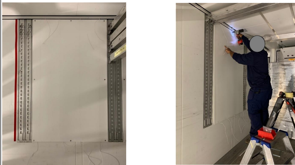
Fot. 9: Przykład paneli zabezpieczających ściany boczne, i sufit podłączonych do alarmu dźwiękowego i telematyki.
