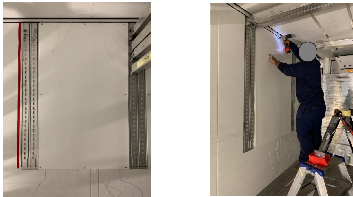
Fot. 8: Przykład paneli zabezpieczających ściany boczne, i sufit podłączonych do alarmu dźwiękowego i telematyki.
